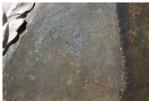
Obr. 1 Detail výjevu na klenbě: obloha v levé části výjevu. Stav před restaurováním. Souvislejší modrozelená vrstva starší druhotné přemalby mastného charakteru. Foto: Adéla Škrabalová.
