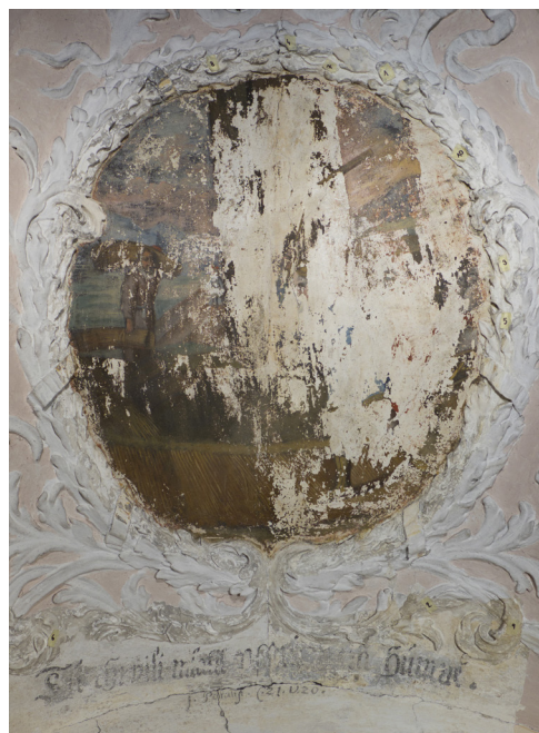
Obr. 5 Celkový pohled na výjev na klenbě. Stav po očištění depozitů a sejmutí přemalob. Foto: Adéla Škrabalová.
