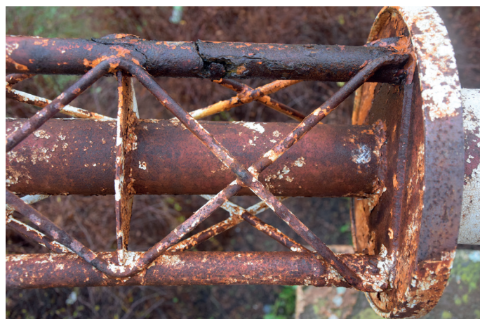
Obr. 22 Plošné i lokální korozní poškození vnějšího kruhového nosníku plastiky, 2016. Foto: Zuzana Křenková
